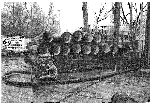
写真 8-2 圧送管(ダクタイル鉄管)
