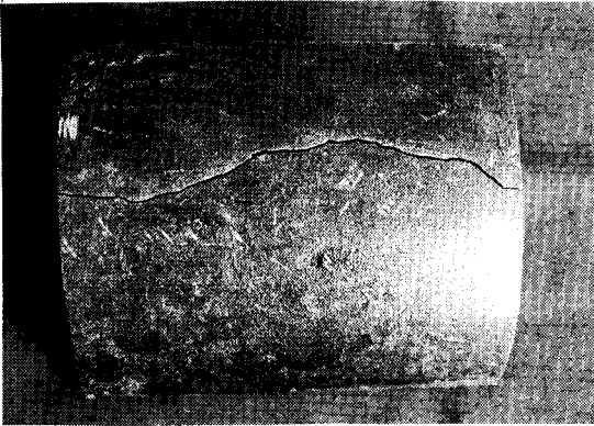
写真-1 輸送管のクラック状況
