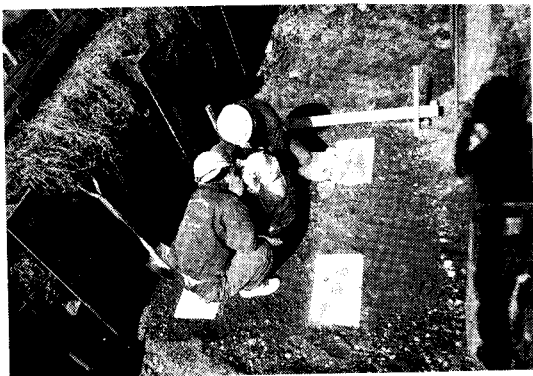
写真-5 下水道用空気弁の設置状況
